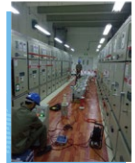
12 新疆浙能阿克苏热电有限公司 1号机组A修6kV开关大修试验
