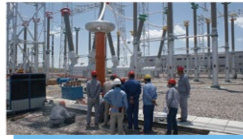
09 宁夏浙能枣泉电厂750kV升压站 设备交接试验
