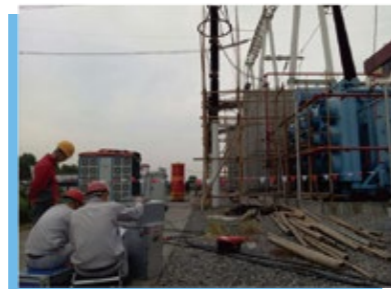
08 国电浙江北仑第一发电有限公司 #7主变C相局放试验
