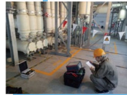
15 浙江舟山电厂220kV GIS开关 SF6气体微水检测
