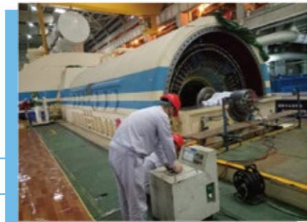
06 浙江宁海电厂1000MVA机组 #5发电机转子交流阻抗测量
